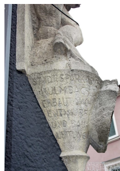
Die beiden Hinweise auf den Architekten sind kaum noch zu lesen.
